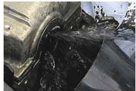
Внимание: при безупречной подаче смазочного масла здесь могут проходить от 30 до 60 л в час.
